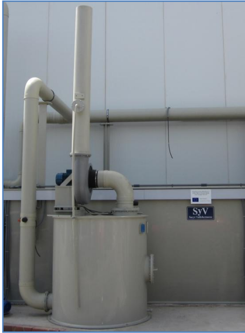
Figura 1. Vista de la planta de carbón activo.
