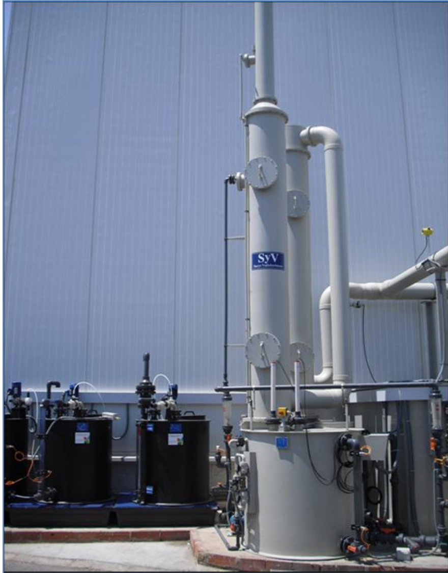
Figura 1. Planta piloto lavado químico. EDARi Helados Alacant.
