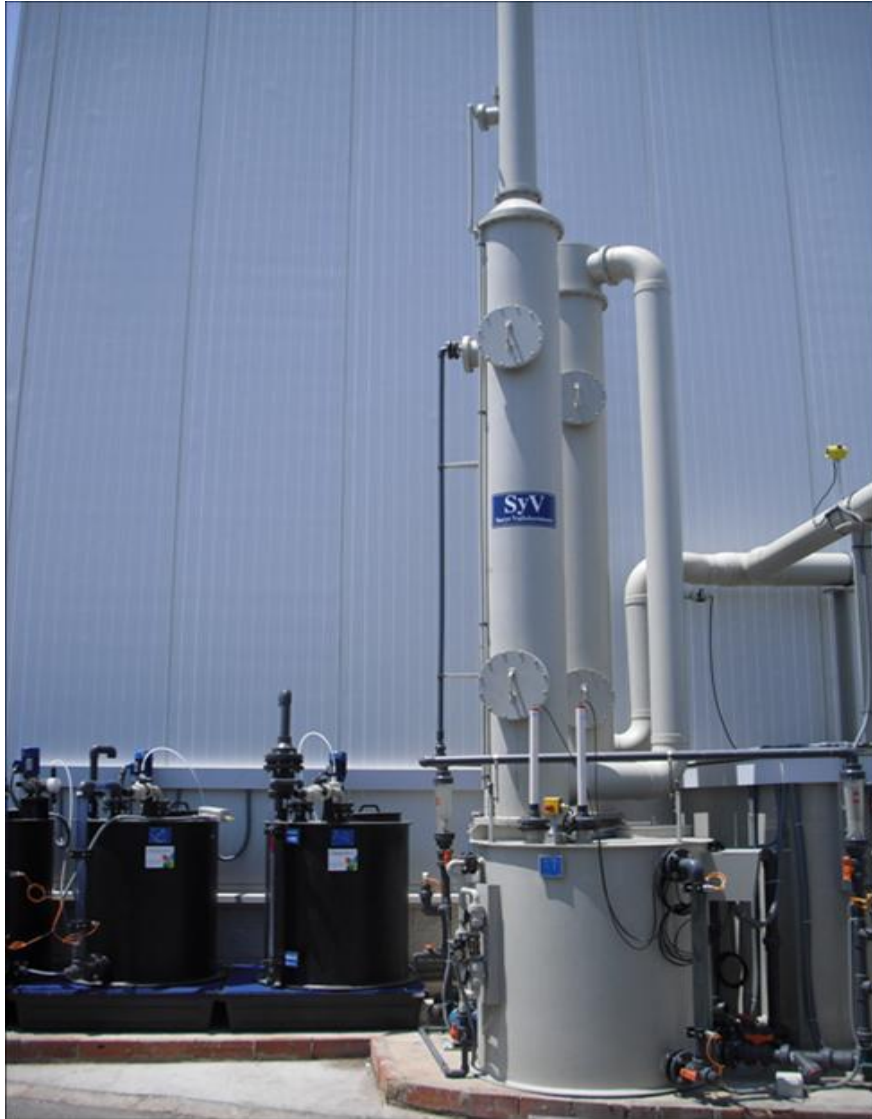
Figura. 2 Planta piloto lavado químico. EDARi Helados Alacant
