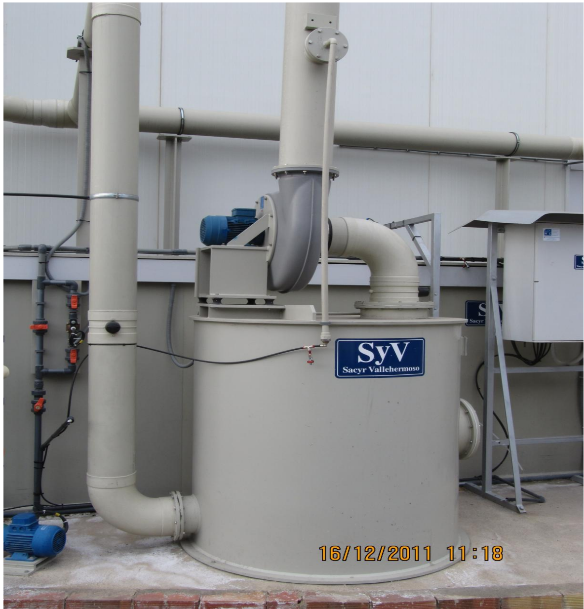
Figura 4. Vista de la planta de carbón activo
